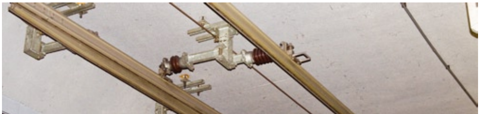
Doppelte Fahrleitung für die Sihltal- und Uetlibergbahn
